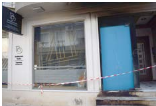
Ζημιές στην πρόσοψη του κτιρίου
