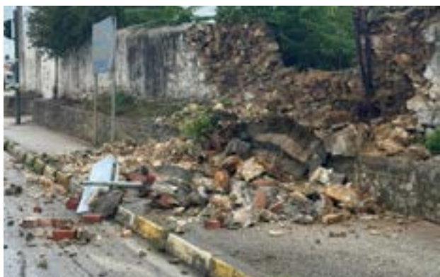
Το τοίχιο κατέρρευσε μετά τις τελευταίες βροχές
