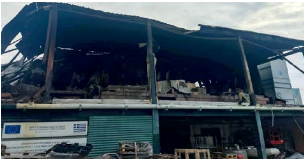
Ο ψεκασμός γίνεται μόνο περιμετρικά, αφού η πρόσβαση στο εσωτερικό του χώρου είναι αδύνατη, καθώς τα ζωικά υπολείμματα βρίσκονται κάτω από την ετοιμόρροπη στέγη — για την οποία, άλλωστε, έχει ήδη κατατεθεί αίτημα κατεδάφισης.
