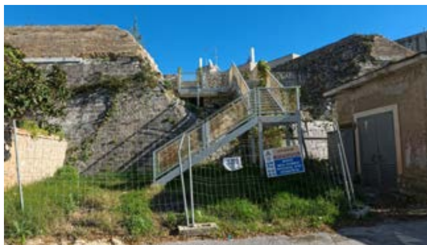
Ανολοκλήρωτο (από δεκαετίας) έργο ανάδειξης βενετσιάνικου περιμετρικού τείχους (μνημείο της Unesco).
