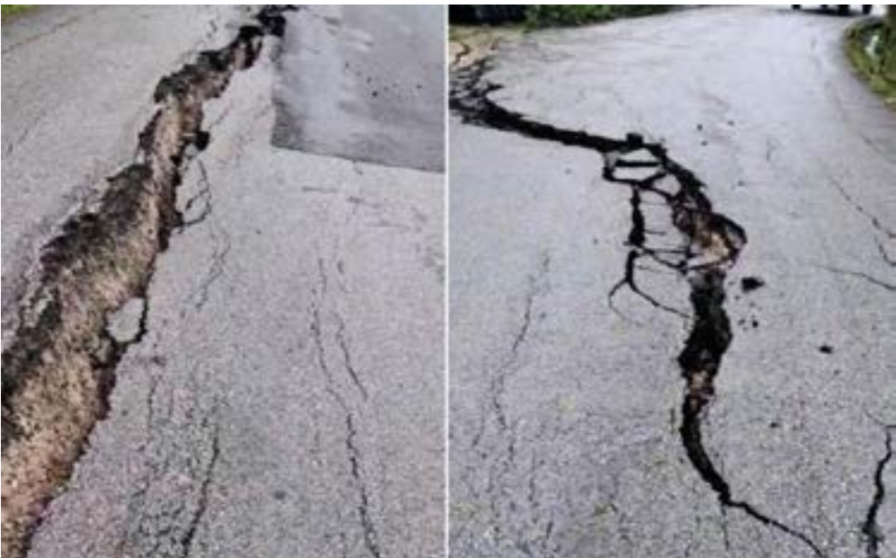
Από την καθίζηση του οδοστρώματος στην περιοχή Πάγοι – Πρινύλα
