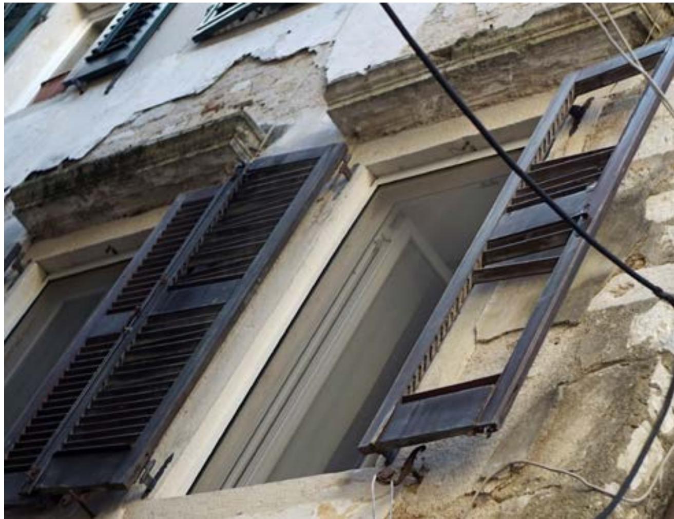
Τα σημάδια της φθοράς στα κτίρια της παλιάς πόλης
