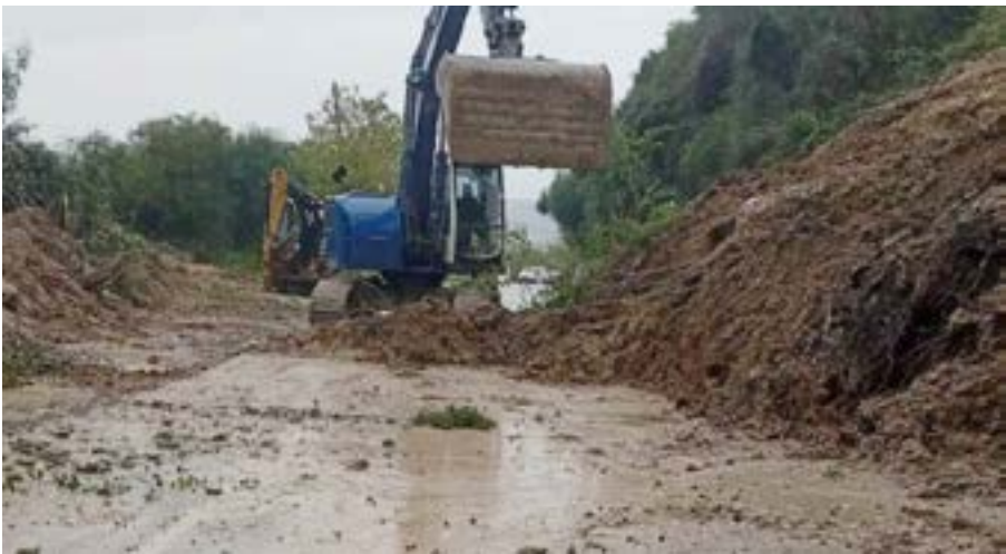
Οι μέχρι σήμερα εξαγγελίες της Κυβέρνησης και εκπροσώπων της Τοπικής Διοίκησης για χρηματοδότηση έργων αποκατάστασης είναι ανεπαρκείς και καθυστερημένες.
