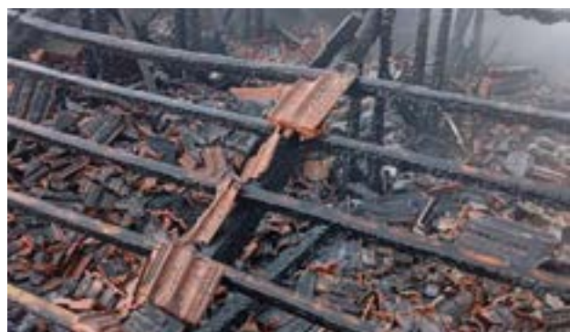
Η στέγη κάηκε ολοσχερώς
