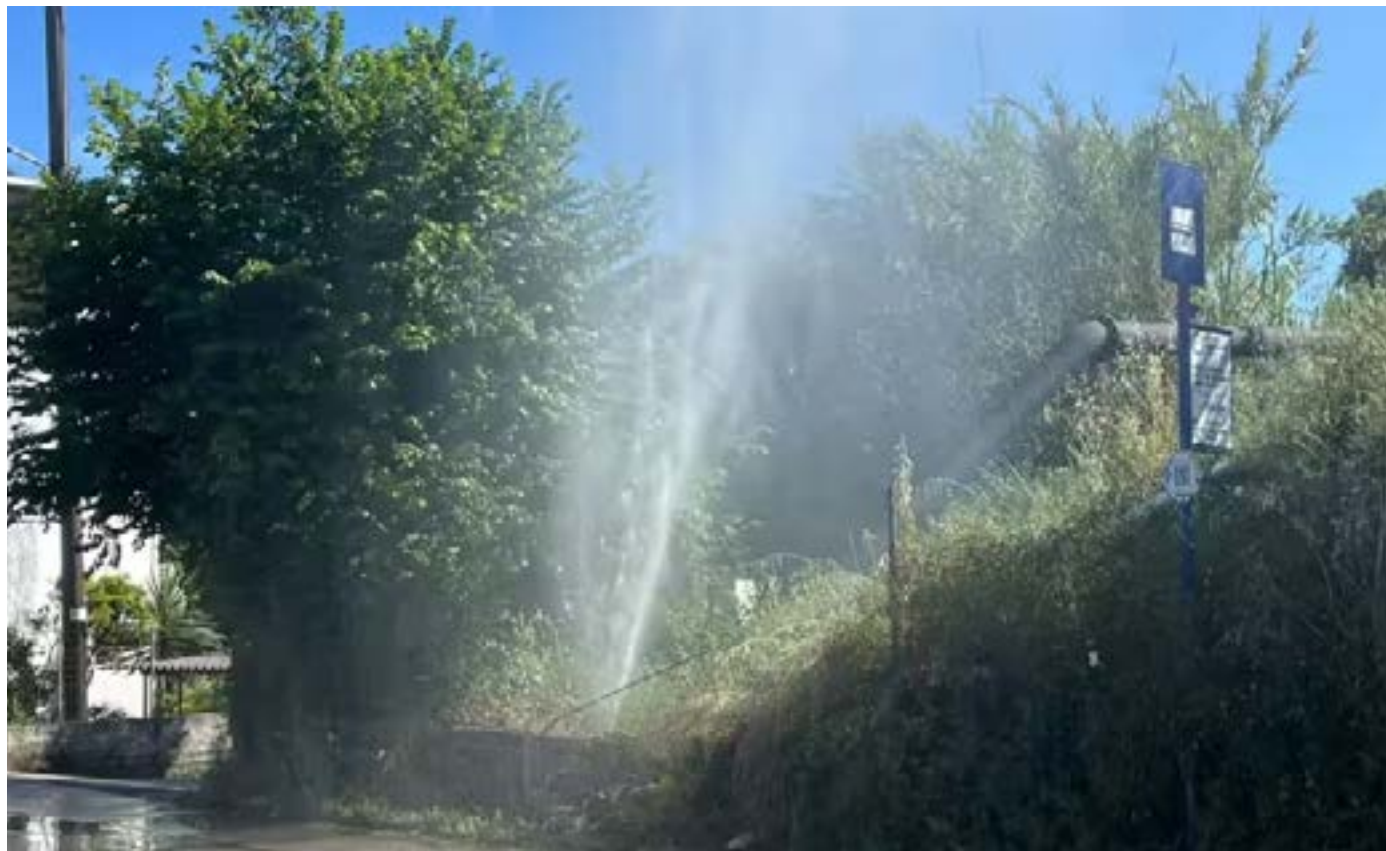
Μεγάλη η απώλεια νερού στον αγωγό από την Χρυσήδα. Όσο περνάει ο καιρός πυκνώνουν και οι βλάβες.
